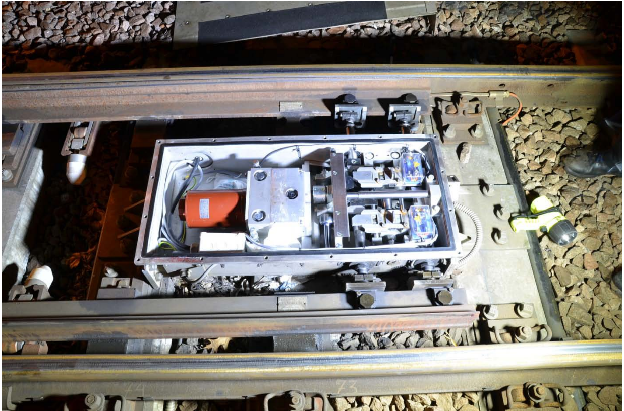
Foto 5: Weichenantrieb und Verriegelung W108
